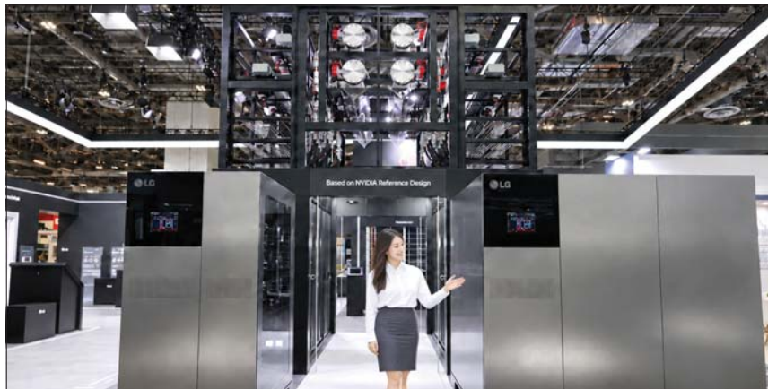
LG전자가 29일 싱가포르에서 개막한 ‘데이터센터월드 아시아 2026’에 참가해, 엔비디아 규격 승인을 받은 1MW와 2.6MW 냉각수분배장치(CDU)를 포함한 AI 데이터센터 냉각 솔루션을 선보인다. /LG전자
