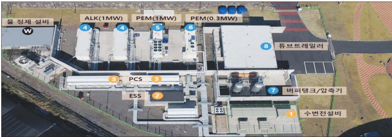
제주시 구좌읍 행원 3.3MW 수전해 실증단지 전경
