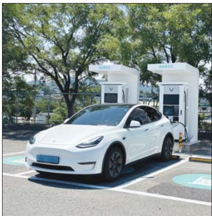
고속도로 휴게소에 설치된 채비 충전기 사진. /채비
