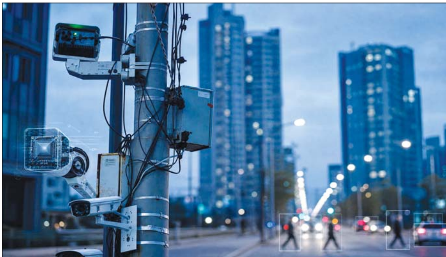
ChatGPT에 의해 생성된 AI CCTV 엠티박스가 설치된 모습을 구현한 이미지.
