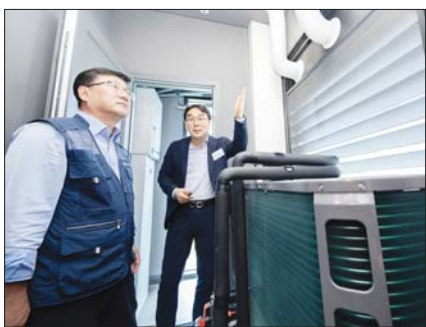
김성환 기후에너지환경부 장관이 22일 경기 용인시 삼성물산 주거성능연구소를 방문해 히트펌프 실증 현장을 점검하고 있다. /기후에너지환경부
