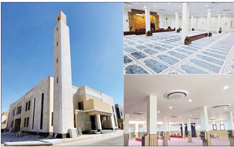
사우디 모스크에 천장형 시스템에어컨 ‘360 카세트’가 설치된 모습. /삼성전자
