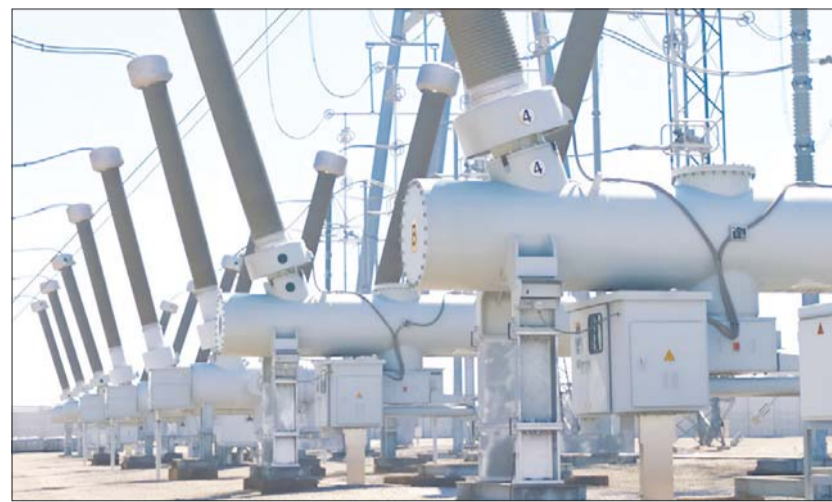
미국 전력망에 설치된 효성중공업 초고압차단기 모습.
