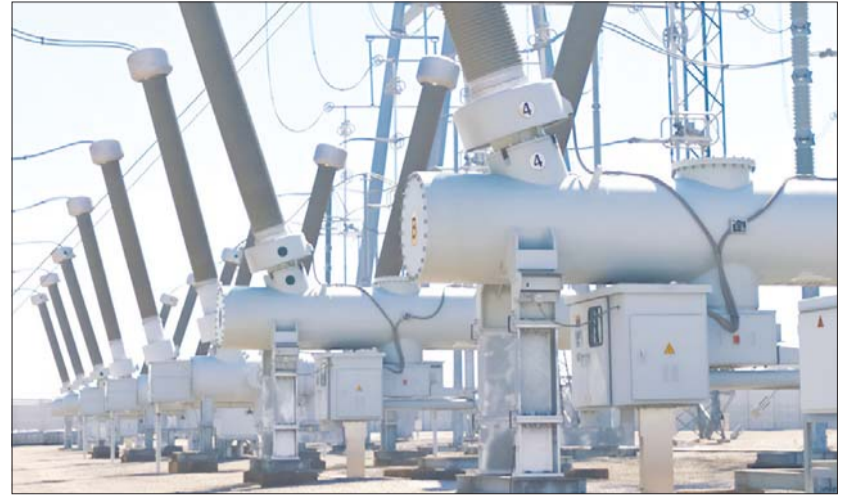
미국 전력망에 설치된 효성중공업 초고압차단기 모습.
