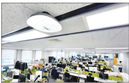
서울 용산사옥에 설치된 와이파이 7 공유기. /LG유플러스
