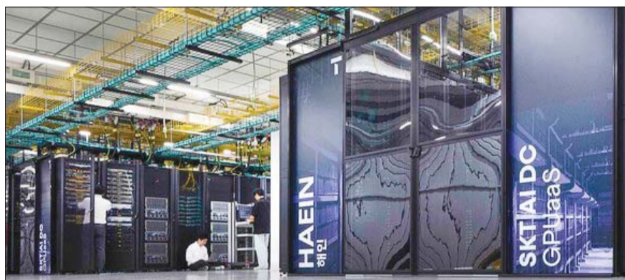
SK브로드밴드 가산 AI DC에 구축된 B200 클러스터 '해인'의 내부 모습. SK텔레콤은 가산 AI DC에 H100에 이은 최신 B200 GPU 클러스터를 조성했다. /SKT
