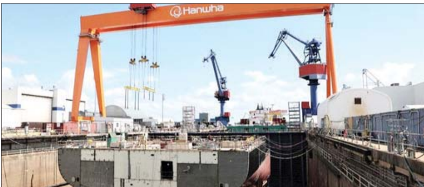
미국 펜실베이니아주 필라델피아의 한화 필로조선소 4번독(도크)에서 국가안보다목적선박 건조 작업이 진행되는 모습. /한화오션
