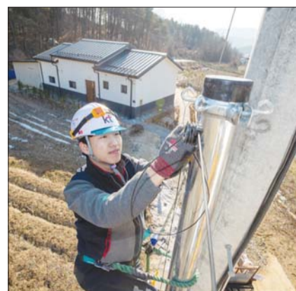
KT는 '무선망 기반 시내전화 서비스'가 과학기술정보통신부의 ICT 규제샌드박스 실증특례로 지정됐다고 6일 밝혔다. 사진은 KT가 국내의 산간 오지 지역에서 보편적 통신 서비스를 위해 통신망을 구축하는 모습. /KT
