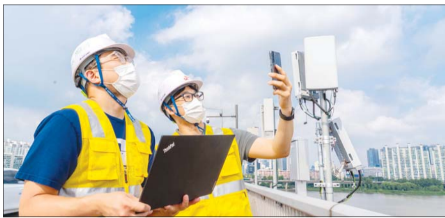
SK텔레콤 엔지니어가 5G 상공망 안테나 장비를 점검하는 장면.
