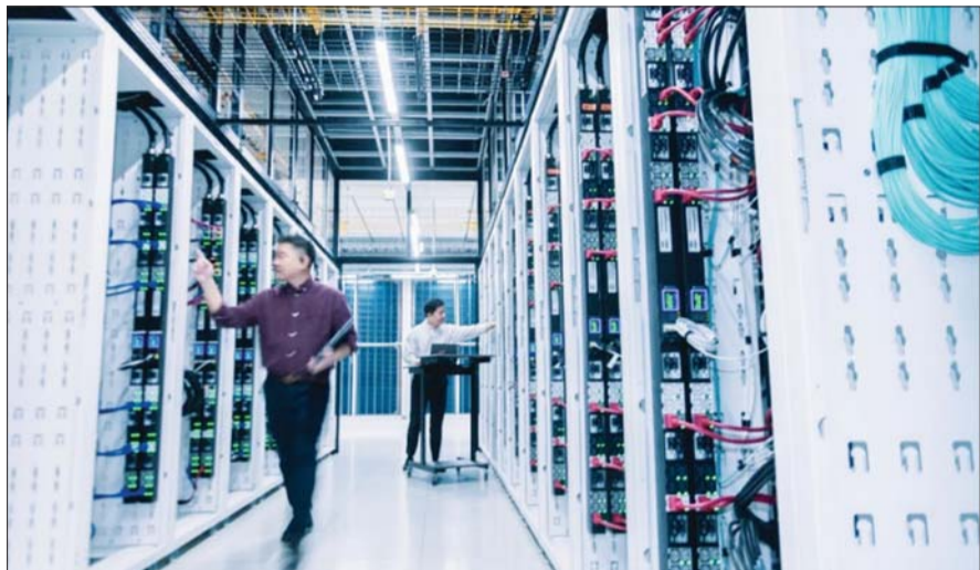
전력 규제를 완화해 AIDC 구축 속도를 끌어올리는 내용을 골자로 한 '인공지능 데이터센터 특별법'이 과방위 전체회의를 통과했다. 사진은 가산 AI DC에서 SKT 직원들이 시스템을 점검하고 있는 모습. /SKT
