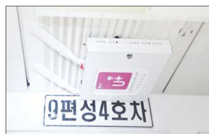
3호선 객차 내에 5G 라우터가 설치된 모습. /LG유플러스
