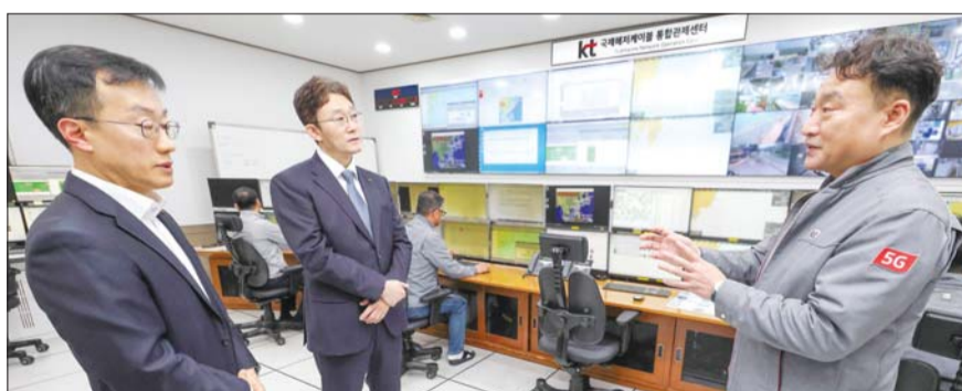
KT 박윤영 대표(가운데)가 KT국제통신센터의 국제해저케이블 통합관제센터에서 국제해저케이블 데이터 트래픽 운용 상황 점검하고 있다. /KT
