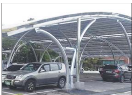
공공주차장에 캐노피형 태양광 발전설비가 설치된 모습. /뉴시스
