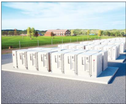
LG에너지솔루션의 전력망용 ESS 배터리 컨테이너. /LG에너지솔루션
