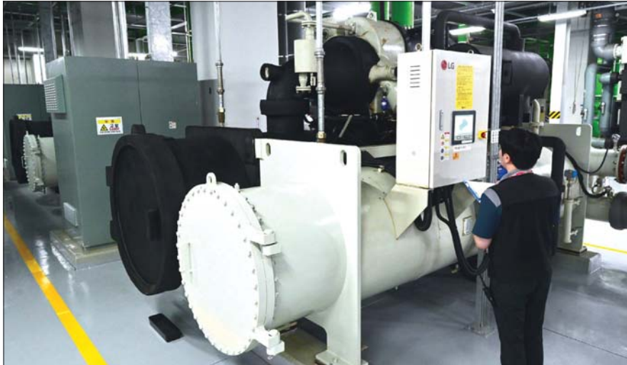
LG전자가 8일 서울 강서구 마곡 LG사이언스파크에서 기자간담회를 갖고 ES사업본부의 사업 전략방향과 AI 데이터센터향 HVAC 솔루션 등을 소개했다. 마곡 LG사이언스파크 메인 기계실에 설치된 터보 칠러. /LG전자
