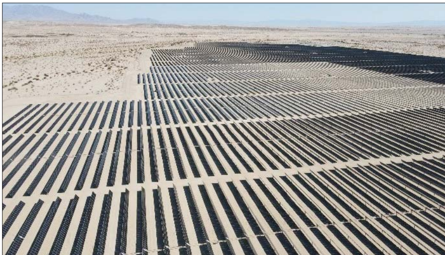
한화큐셀이 완공한 미국 캘리포니아 주 소재 태양광 발전소(50MW)
