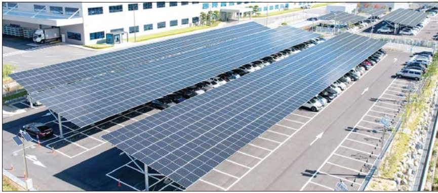
현대모비스 울산동화공장 태양광 발전 패널.
