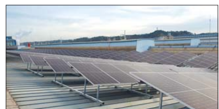
동국제강 포항공장 지붕에 설치된 태양광 자가발전 설비.
